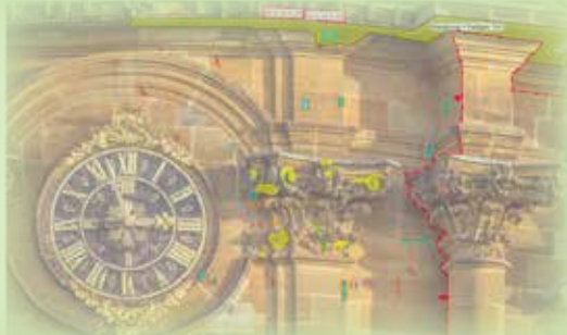
Schäden an den Kapitellen
